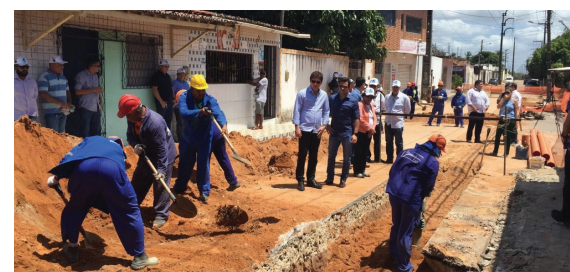
O esgotamento sanitário é um dos quatro pilares do saneamento
